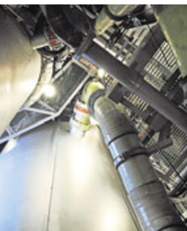
Blick auf den Scrubber. Der sitzt in einem 15 Meter hohen Stahlkasten.
