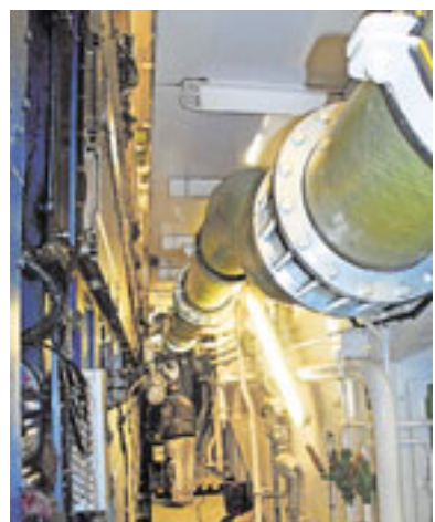
Durch neue Riesenleitungen wird das Wasser gepumpt.
